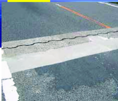
段差・隙間部分
