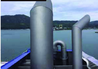
ファンネル上部
